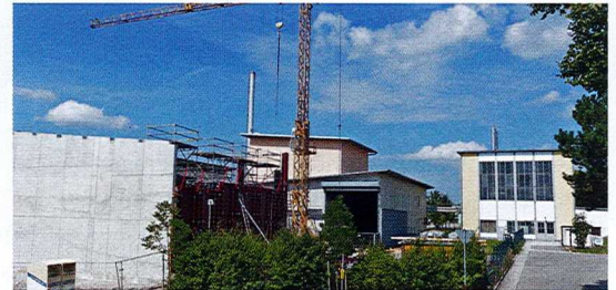
Wo früher ein US-amerikanisches, mit Kohle befeuertes Heizwerk für die Flint-Kaserne stand, betreiben heute die Tölzer Stadtwerke ein Hack-schnitzelheizwerk, das momentan erweitert wird
